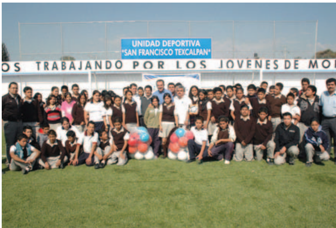
Colocación de pasto sintético en la cancha de fútbol de la unidad deportiva San Francisco Texcalpan 2ª etapa.
