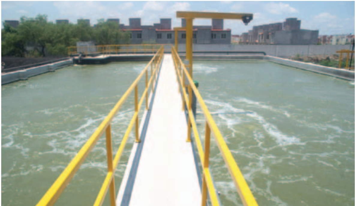
Planta de tratamiento de aguas residuales del Río Apatlaco en el tramo de Xochitepec.
